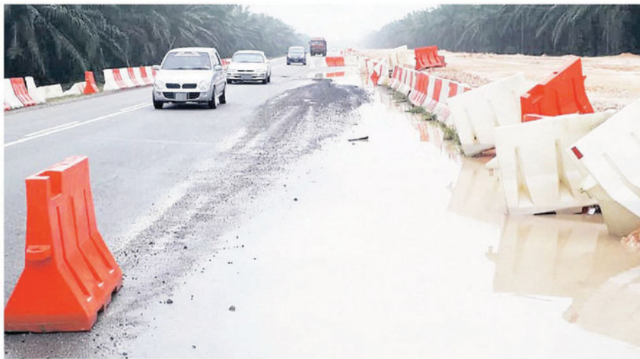
Pembahagi jalan yang diletakkan di laluan tanpa sebagai tanda amaran mengundang bahaya kepada pengguna terutamanya pada waktu malam.
